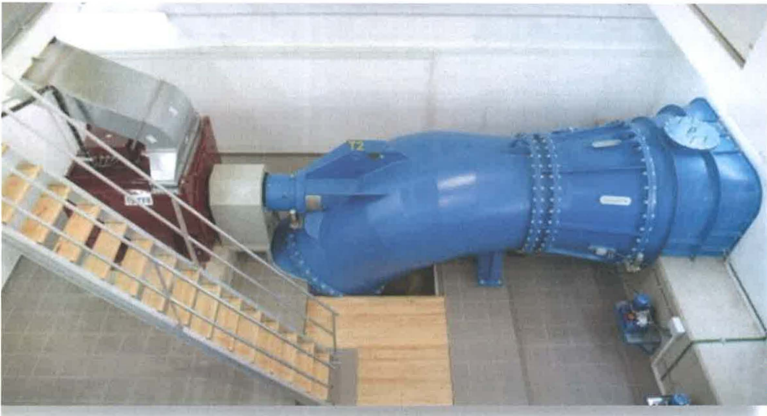
Slika ugrađene kapaln S turbine u postrojenju
